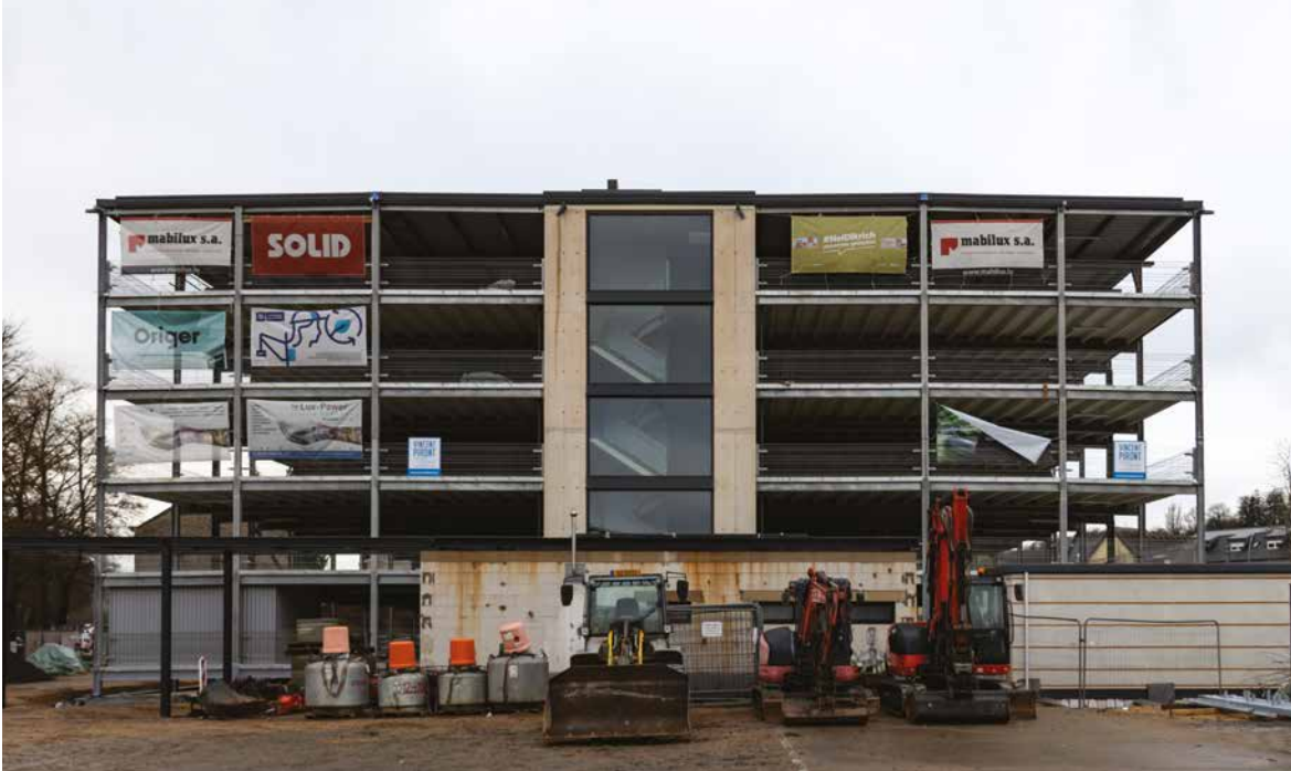
Parkhaus an der Avenue de la Gare / Parking de l'avenue de la Gare.
