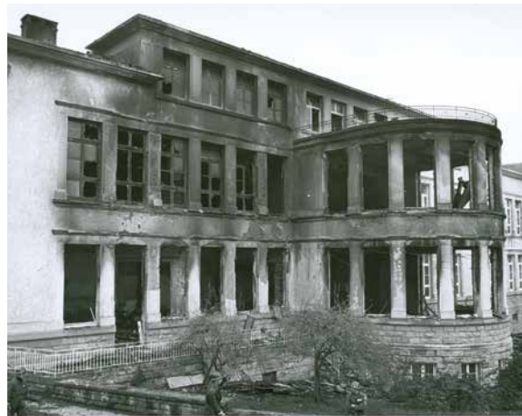
Das Gebäude nach der Feuersbrunst. (Quelle: Gemeindegarchiv Diekirch)
